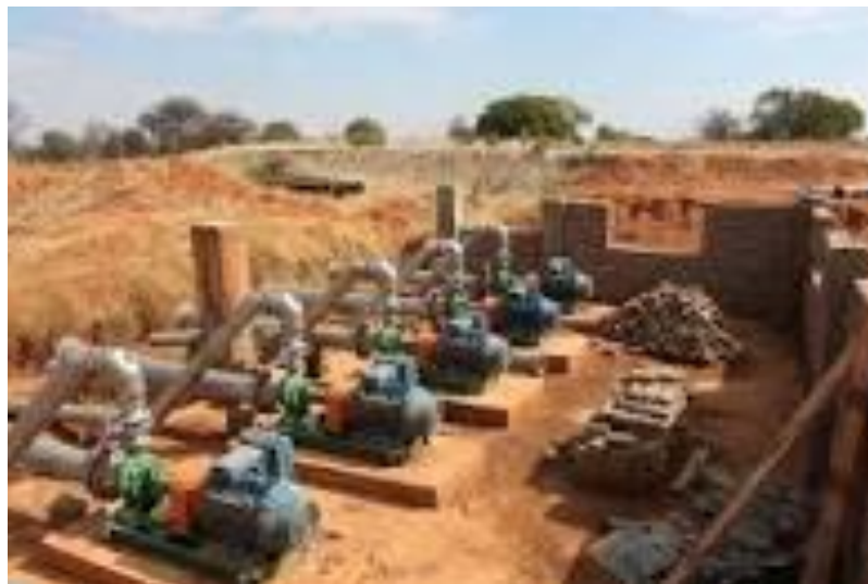
Pompes à eau d'un système d'irrigation dans la province du Matebeleland
